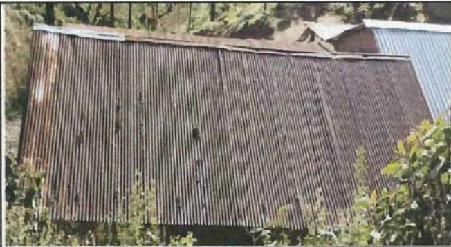
Foto 1: Vista del techo del establecimiento que necesita sustitucion por laminas troqueladas
