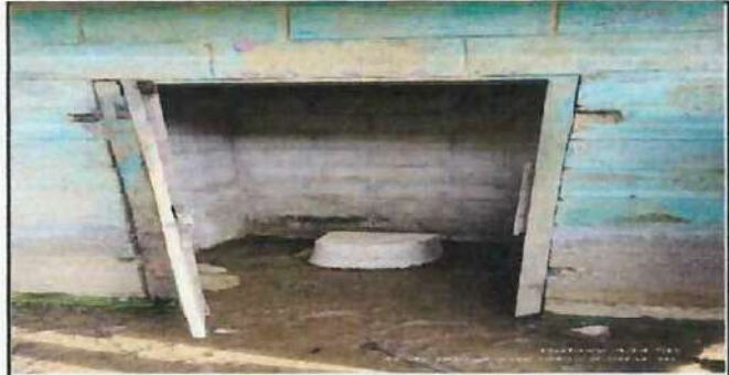
Foto 2: fotografia del servicio de sanitario, evidencia la necesidad de mejoras.
